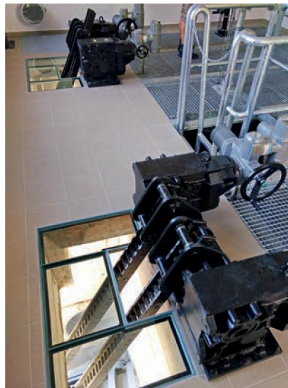
Pohled na nové ovládání segmentových uzávěrů (archiv Povodí Vltavy, státní podnik)
