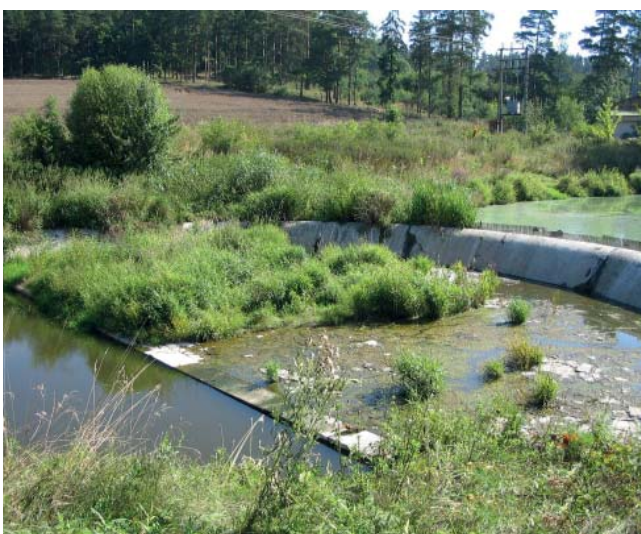
Nežádoucí stav bezpečnostního přelivu (vegetace, poškozené česle, praskliny)
