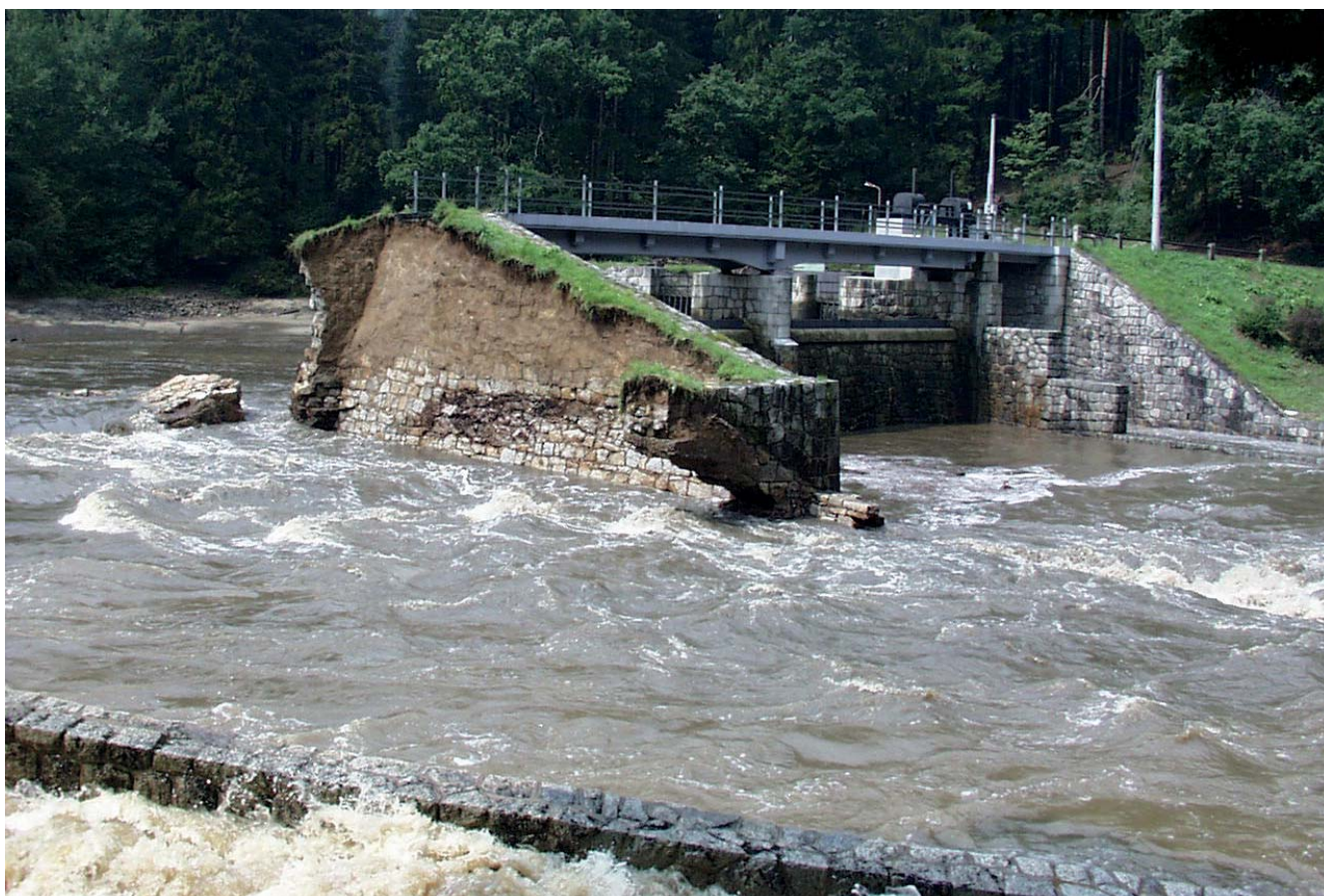
Destrukce hráze údolní nádrže Soběnov v roce 2002
