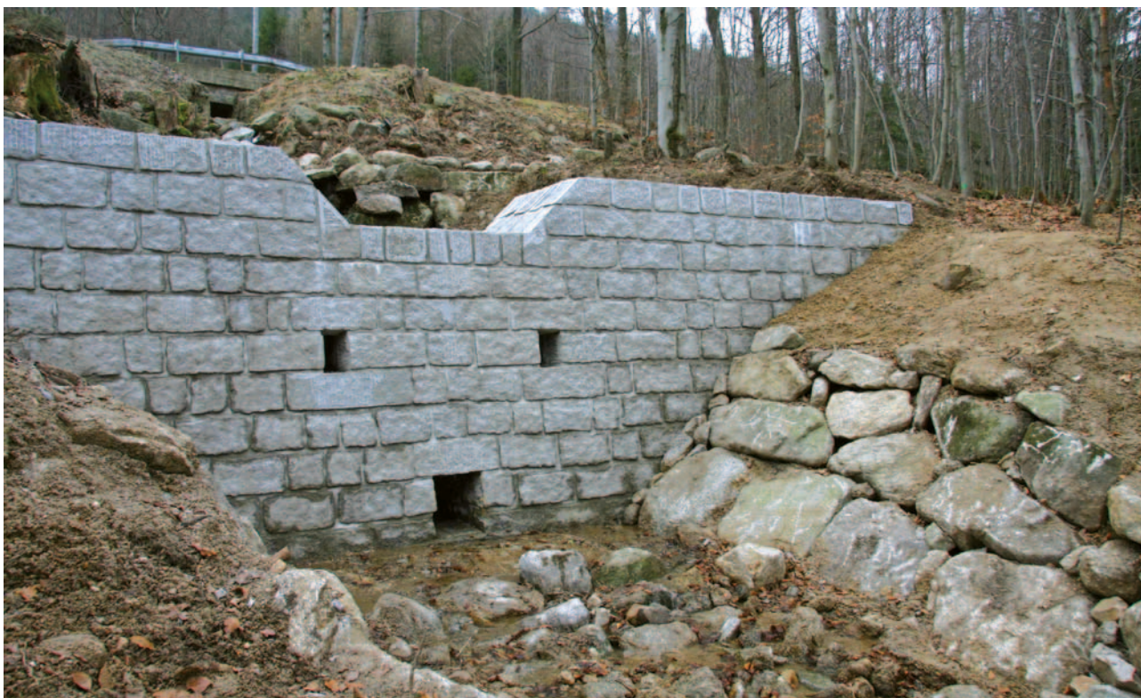
Obrázek 4-22: Pohled proti vodě na konstrukci konsolidační přehrázky z kamenného hrubého řádkového zdiva. Jedná se o kombinovanou konstrukci – betonové jádro s kamenným obkladem z vodorovně provázaného hrubého kamenného řádkového zdiva. Na konci je spadiště stabilizováno zděným kamenným pasem, pod kterým koryto přichází do kamenné rovnániny. Využití řádkového zdiva se pro kombinované (betonovo-kamenné) konstrukce doporučuje s ohledem na rozměrové a kvalitativní požadavky na lomový kámen.
