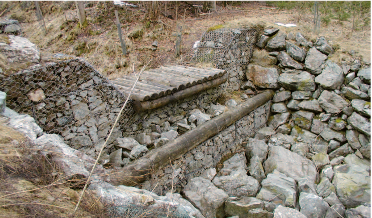
Obrázek 4-32: Detail na zpevnění přelivu a nižších gabionových sekcí pomocí kmene a ochranného kamenného záhozu. Koše jsou na koruně a v březích zpevněny kamennou rovnatinou, dno je provedeno jako balvanitý skluz.
