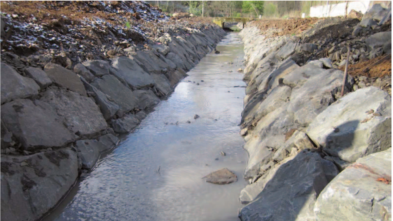
Obrázek 4-52: Pohled na kamennou rovnatinu, resp. na kamenný obklad prováděný v pravidelném lichoběžníkovém korytě. Konstrukci je nutné prosypávat kamenem, aby mezi rubem kamene a výkopem vznikla filtrační zóna a vrstva, která zaručí nemytí půdních částic.
