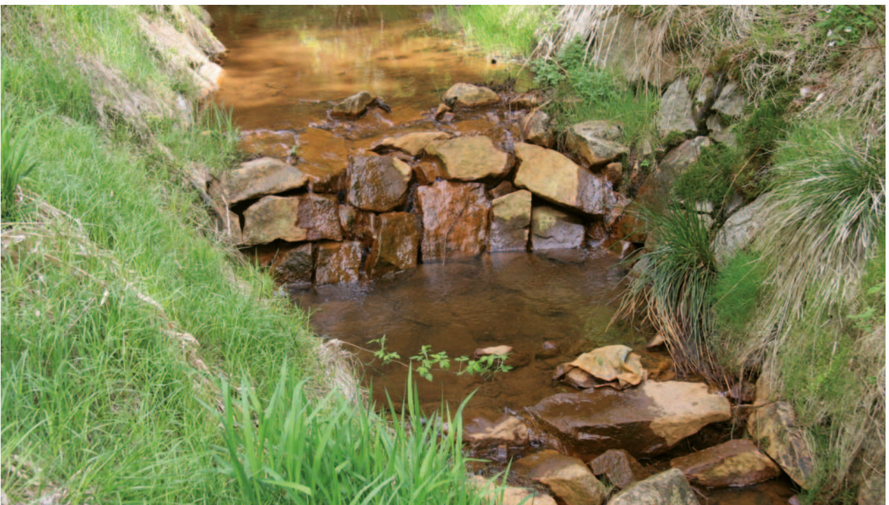
Obrázek 4-8: Pohled na úpravu podélného sklonu pomocí kamenného prahu z kamenné rovinaniny na suchu, která plynule přechází ve stabilizovaný výmol. Jedná se o přírodě blízký prvek bez použití cementu. Objekt je vhodný do pramenných lokalit horských a podhorských potoků, kde je požadována úprava koryta přírodě blízkým způsobem.
