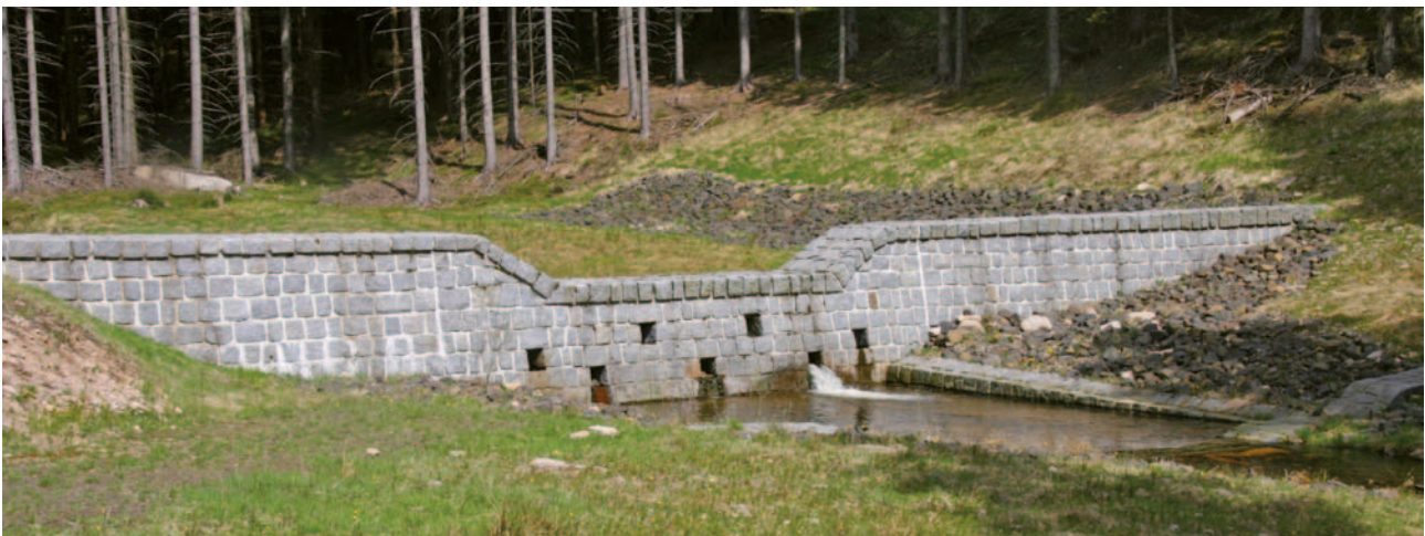
Obrázek 4-24: Pohled proti vodě na těleso retenční betonové přehrážky s oblakem z hrubého řádkového zdiva. Na fotografii je patrné postupné zdění objektu přehrážky ve třech sekcích s dilatační spárou (samostatně budovaná zavazovací křídla a následně vylévání přelivné sekce s průřeznými otvory). Líc a přelivná hrana včetně koruny je obložena kamenným zdivem z žulových hranolů. V místě navázání kamene jsou velmi často patrné poruchy a porušení dilatačních spár (viz pohled na rub přehrážky – následující stránka).
