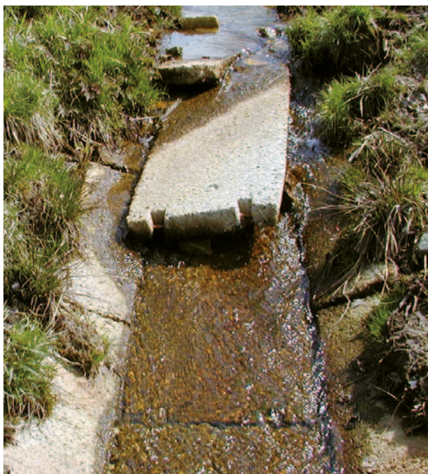
Obrázek 4-43: Opevnění dna a paty břehů podhorského potoka pomocí betonových panelů. Patrné je porušení dlažby po průchodu povodňových průtoků.
