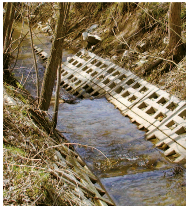
Obrázek 4-44: Ukázka opevnění koryta vodního toku pomocí zatravnňovacích polovegetačních tvárnic. Patrné je porušení opevnění po průchodu povodně.
