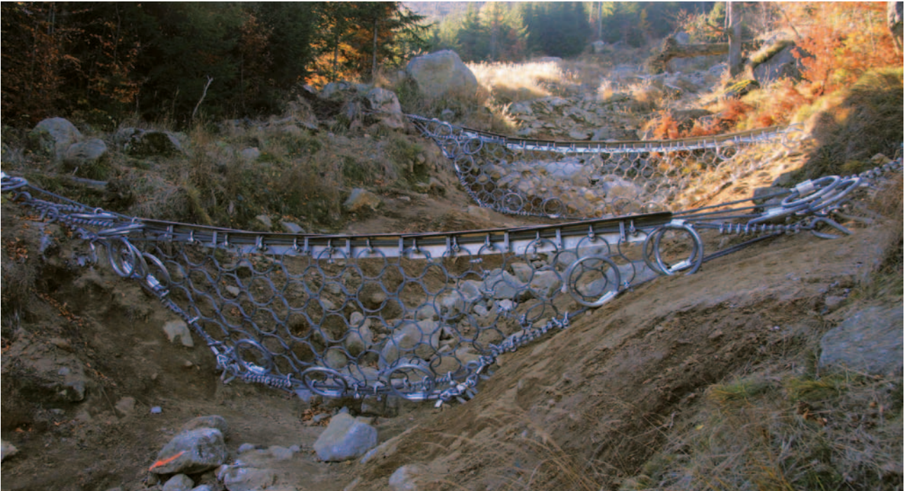
Obrázek 4-67: GEOBRUGG systém použitý pro hrazení strže na Smědavské hoře. Systém je tvořen soustavou dvou flexibilních dynamických bariér umístěných ve svahu kamenné strže. Patrná je kruhová síť uchycená na nosná lana, v přední horní části bariéry jsou patrné brzdové kruhy. Dynamická bariéra se používá hlavně z důvodu zastavení chodu velkých splavenin, padání uvolněných kamenů, popř. se dá použít na zachytávání splaví.
