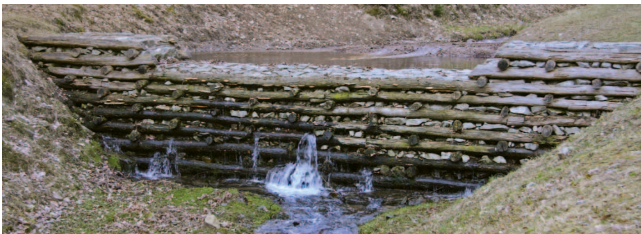
Obrázek 4-35: Srubová přehrážka na Loučenském potoce před plánovanou rekonstrukcí. Pohled na srubovou konstrukci retenční přehrážky s nosnou konstrukcí z kulatiny. Příčné a podélné dřevěné konstrukční prvky jsou spojovány pomocí kovaných hřebů, popřípadě jsou spojovány tesařskými spoji. Těleso přehrážky je vyplněno kamenem, aby fungovalo jako tížný objekt. Přelivná hrana a koruna zavazovacích křídel je zpevněna kamennou dlažbou. Stav tělesa srubové konstrukce (po cca patnácti letech od výstavby) je špatný, konstrukce dožila, dřevo je nahnilé. Stavebně technický stav jednotlivých stavebních prvků je do velké míry dán režimem přehrážky, která je díky poměrně velké pórovitosti kamenné výplně v celém svém profilu průcezná (voda protéká celou konstrukcí). Jednotlivé dřevěné prvky díky nestabilním vlhkostním podmínkám trpí velmi často hnilobou.
