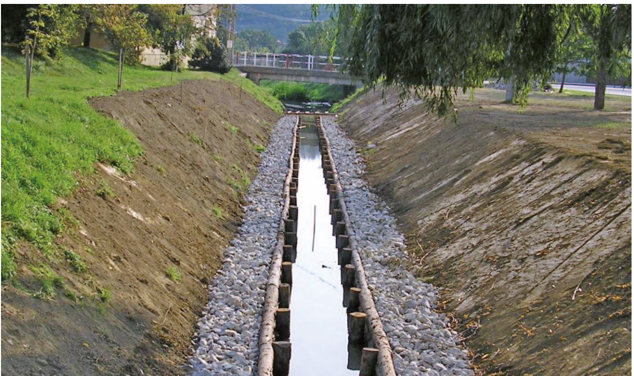
Obrázek 4-41: Ukázka provedeného opevnění paty pomocí plůtku z tyčoviny, nad stabilním průtokem nejčastěji na úrovni Q_{90d} je patrný přechod do opevnění provedeného pomocí zatravnění. Za plůtkem provedeno šterkové lože jako nutná filtrační vrstva.
