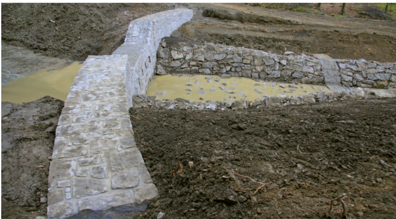
Obrázek 4-25: Pohled na retenční přehrážku z režného kamenného zdiva s obdélníkovými průřeznými otvory. Klenba (resp. půdorysné zakřivení tělesa přehrážky) staticky nevyužívá efektu klenby, jedná se pouze o tvarovou úpravu přelivu a snahu o usměrnění přepadového paprsku do spadiště. Na konci spadiště proveden stabilizační zděný pas a prostor mezi tělesem přehrážky a pasem je opevněn hrubou kamennou rovnatinou s vyklynáváním. Dno je provedeno jako hrubá kamenná dlažba, aby docházelo k tlumení energie protékající vody.
