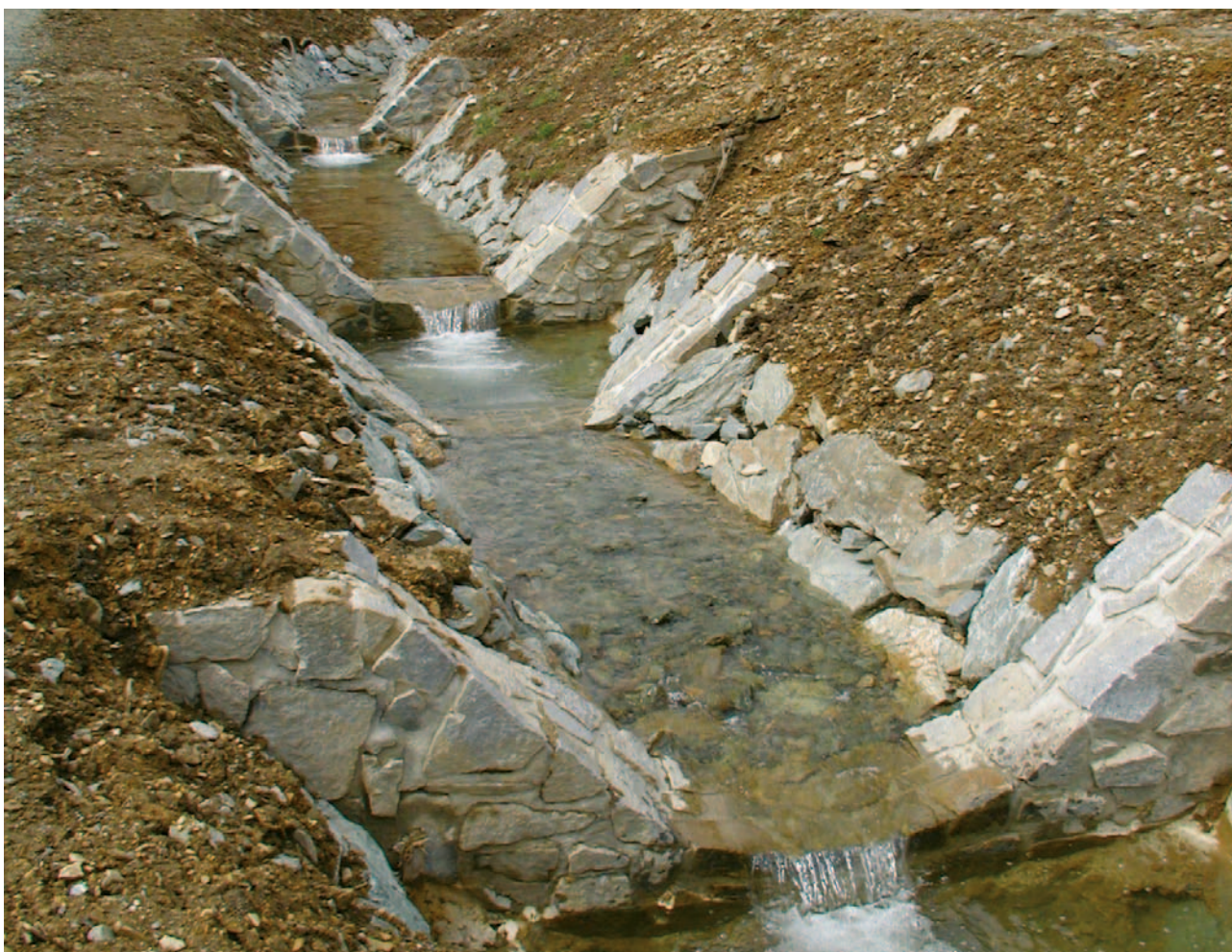
Obrázek 4-10: Pohled proti vodě na soustavu zděných prahů s vývařisti. Mezi jednotlivými stabilizačními prahy a pasy je koryto zpevněno kamennou rovnaninou v březích, doplněnou o kombinaci záhozu a pohozu dna. Jedná se o tvrdou úpravu pomocí zděných prahů, pravděpodobně byla požadována stabilizace koryta v místě, kde při povodni došlo k zahloubení koryta. Jednotlivé objekty a jejich spadiště, resp. vývařisti je nutné hydrotechnicky posoudit a zároveň výpočtem ověřit hloubku a délku jednotlivých vývařistě, resp. stabilizovaných výmolů. Zároveň je nutné posoudit výšku navrhovaného opevnění a následného přechodu ve svah. Na fotografii je zjevné i rozšíření profilu na povodní straně zděných pasů. Kamenné nadzákladové zdivo svou kvalitou a provedeným spárováním neodpovídá požadavkům daným normou pro kamenné zdivo.
