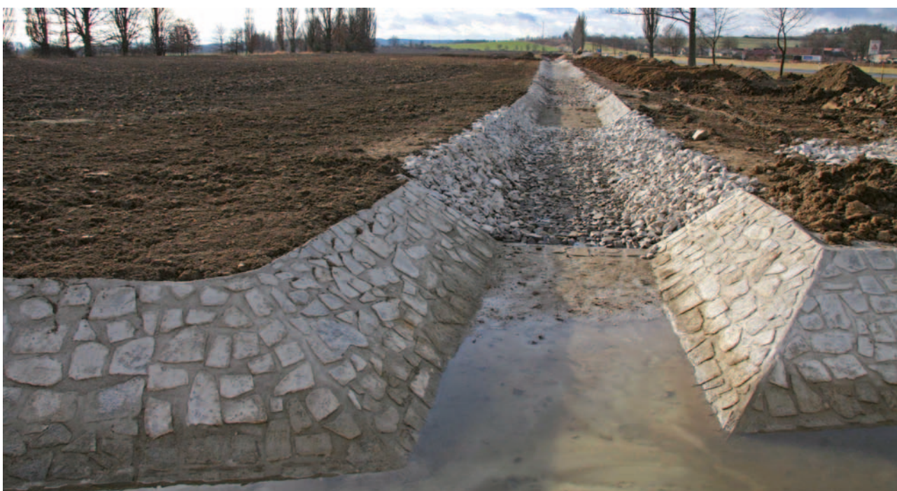
Obrázek 4-46: Opevnění dna a břehů pomocí kamenné dlažby do betonu, místy úprava pomocí kamenného pohozu.
