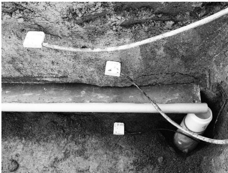
Obr. 1: Rozmístění vlhkostních čidel CS650 a sběrný plech ve stěně drenážního zářezu.
