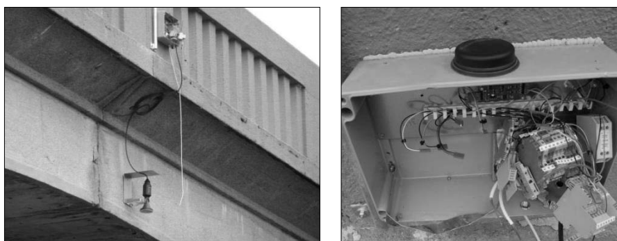
Obr. 6: Ukázka hladinoměrné stanice poškozené vandalismem.
