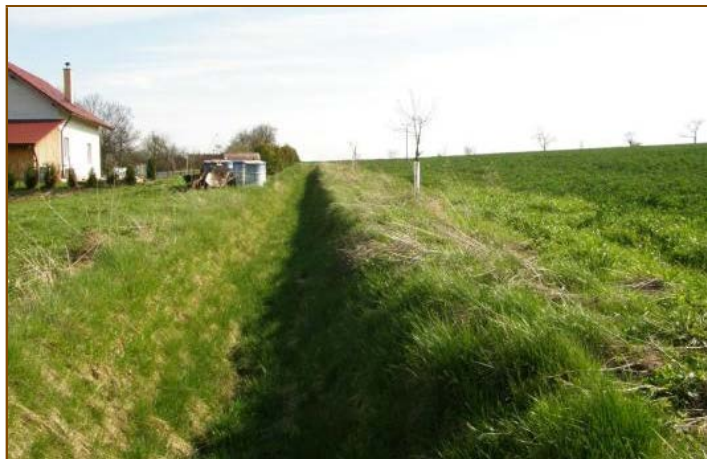
Obr. 4-17: Protierozní záchytný příkop (Rašovice u Uhlířských Janovic, foto VÚMOP, v.v.i.). Díky valu, vzniklému nad příkopem nesprávnou údržbou se voda nemůže dostat do příkopu a teče paralelně po poli.
