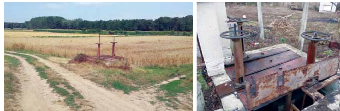
Obr. 2) Vlevo odběrný (nápnstný) objekt [1 dle Obr. 1]; vpravo sdružený regulační a výpnstný objekt [4 dle Obr. 1] v aktuálním stavu údržby. Autoři fotografií: Z. Kulhavý, J. Kozlovsky Dufková.
